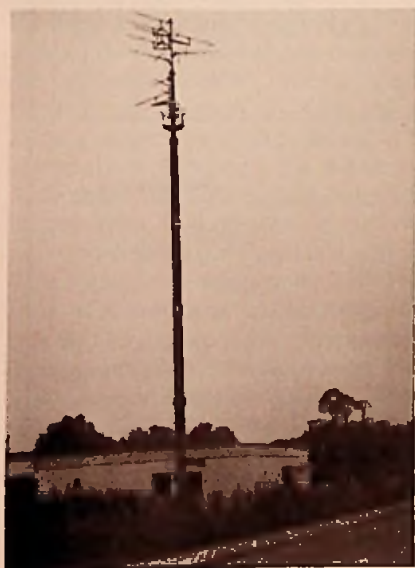
Bild 1. Empfangsantennen auf 30 m-Stahlrohrmast beim Fernsprechamtsgelände
