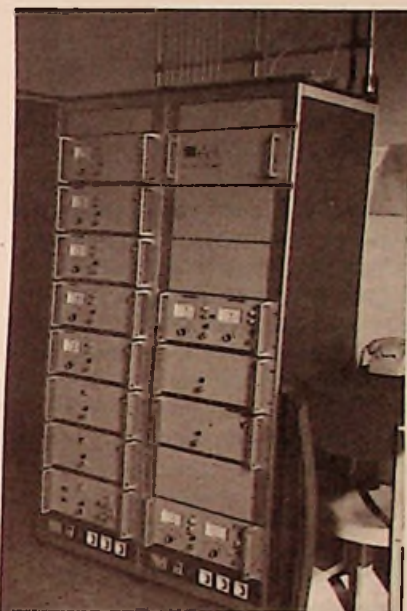
Bild 2. Aufbereitungsanlage im Post-Dienstgebäude links Empfangsgestell, rechts Sendegestell
