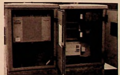
Bild 6. Verstärkerstelle (Nummer 7 in Bild 5) mit einer A-Leitung, zwei abzweigenden B-Leitungen und zwei C-Leitungen. Im rechten Schrank zwei Fernspeise-Netzgeräte
